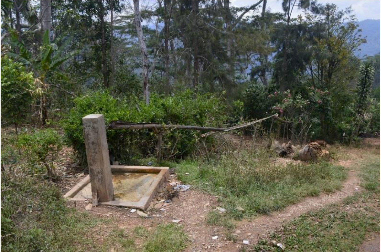
Fotografia 10 - Sistema de distribuição de água na aldeia de Lequice – Tecnologia Fulidaidai-Slulu
